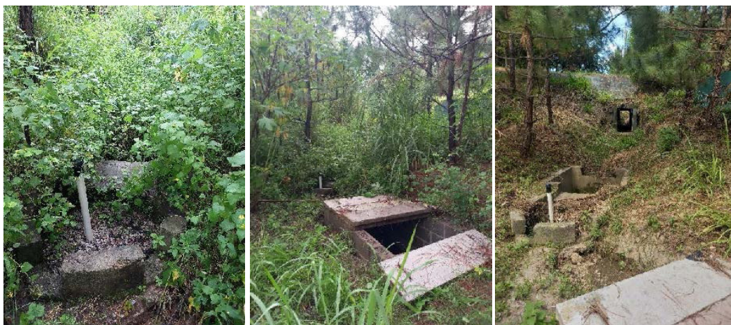
Figura 17. La acumulación de vegetación en el recorrido del agua de escorrentía debe controlarse para que no se desvíe el agua en su ruta hacia la caja de sedimentación y punto de recarga en el pozo.
