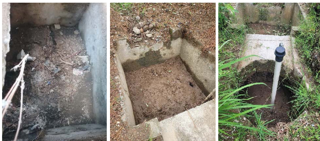
Figura 18. Las cajas de sedimentación deben ser limpiadas previo al inicio de la época lluviosa y periódicamente en la temporada de lluvias para evitar la acumulación de material en las mismas y en la boca del pozo.
